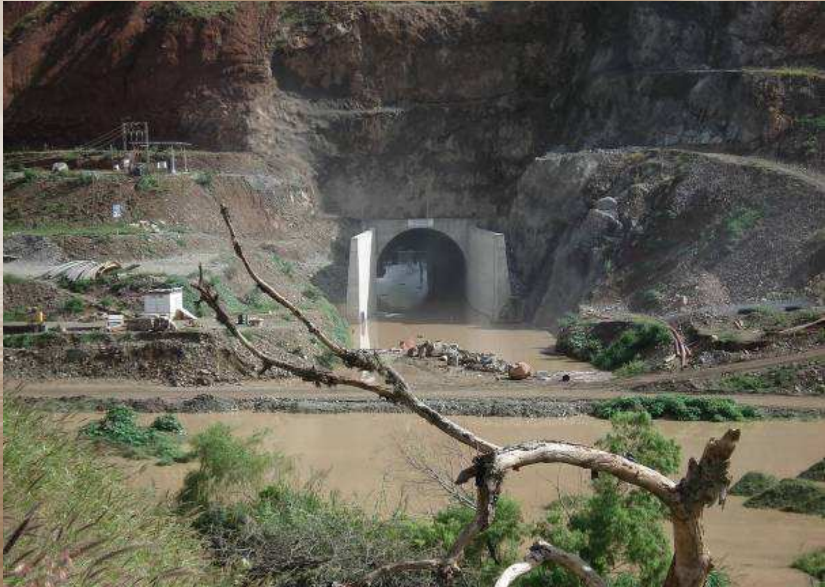
INUNDACIÓN DE TÚNEL DE DESVÍO SALIDA
