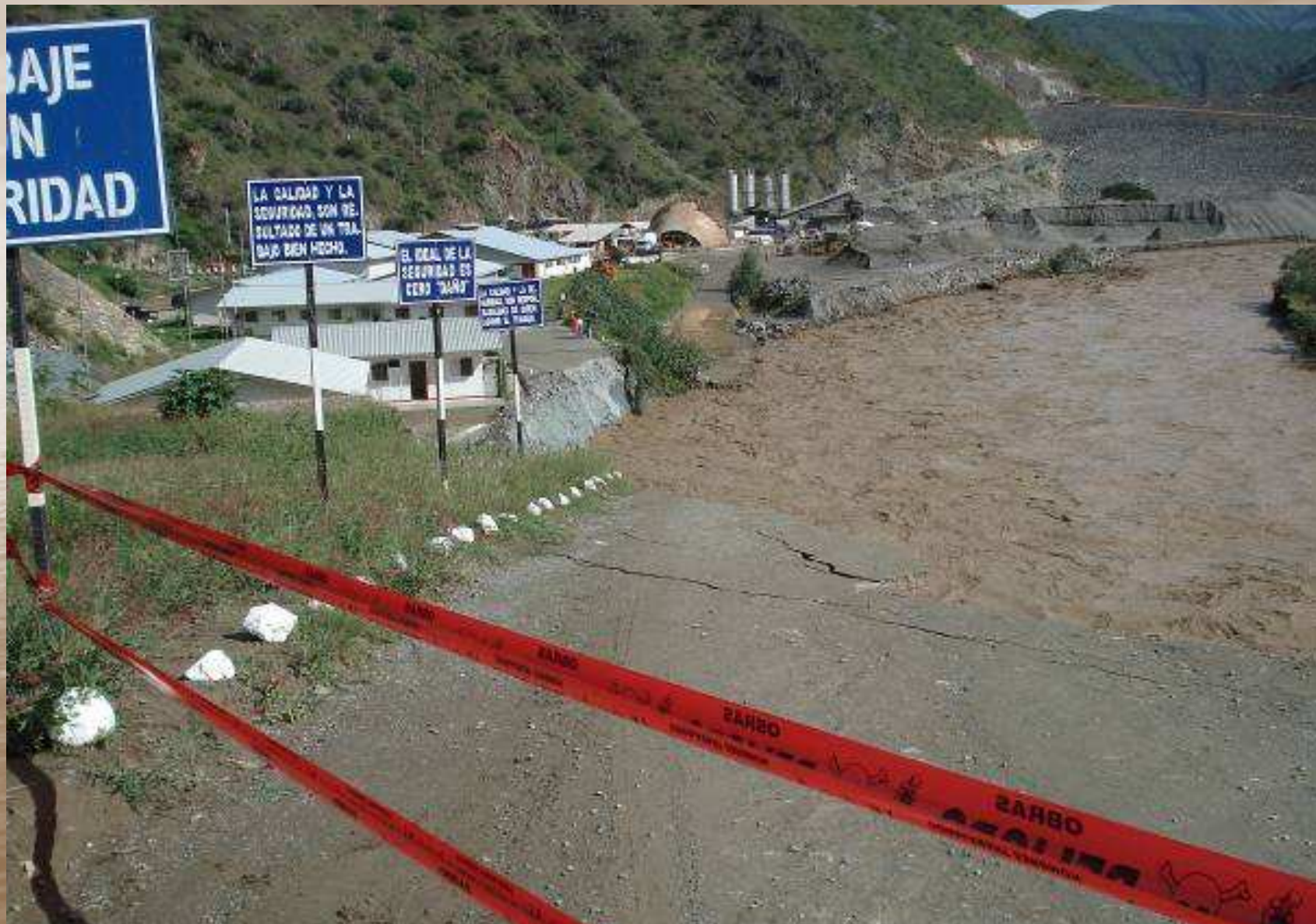
DESTRUCCIÓN DE CAMINO DE ACCESO A OFICINAS Y PLANTAS INDUSTRIALES VISTA AGUAS ABAJO
