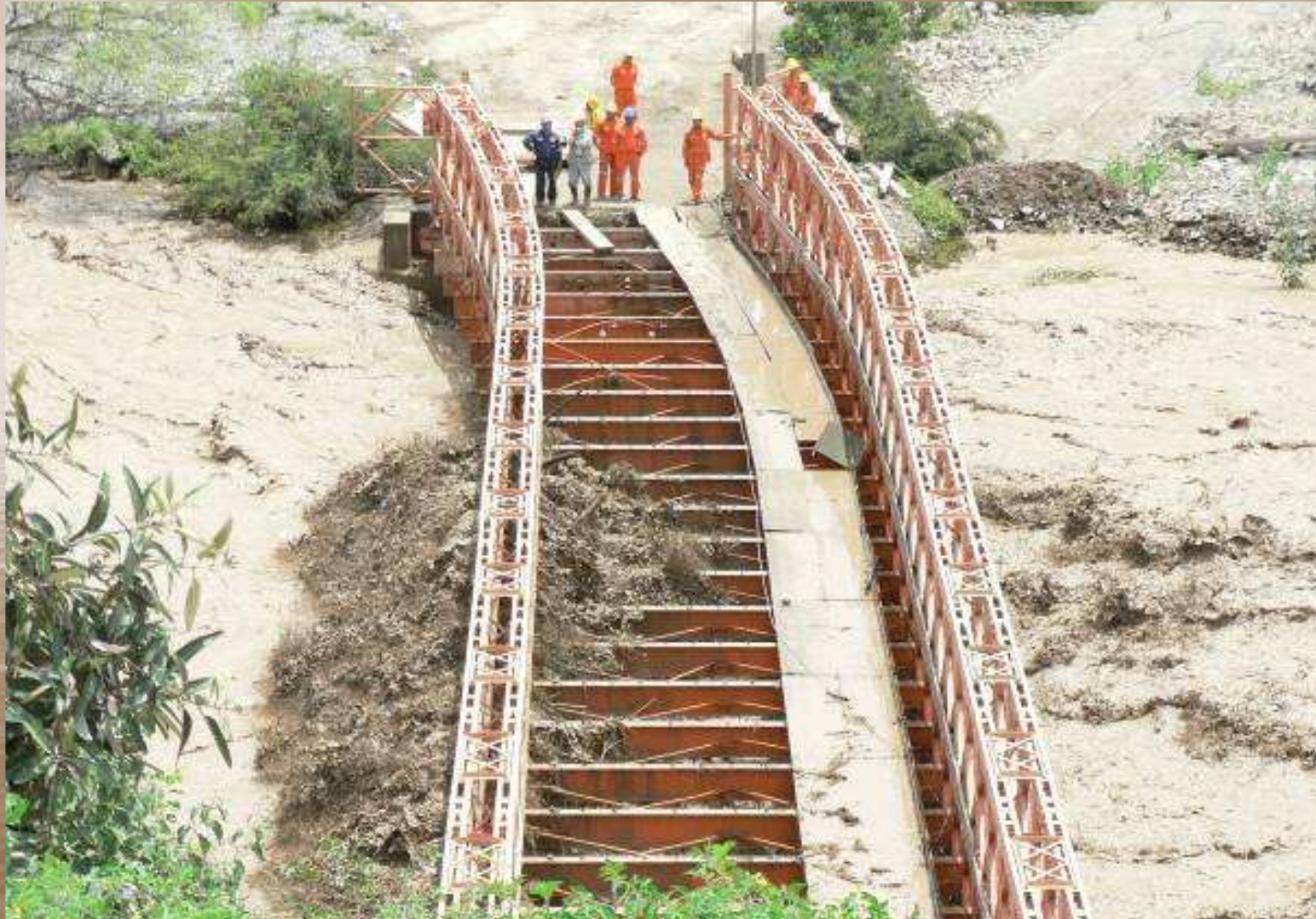
CRECIDA DE RIO SOBRE EL PUENTE Y SU DEFORMACIÓN
