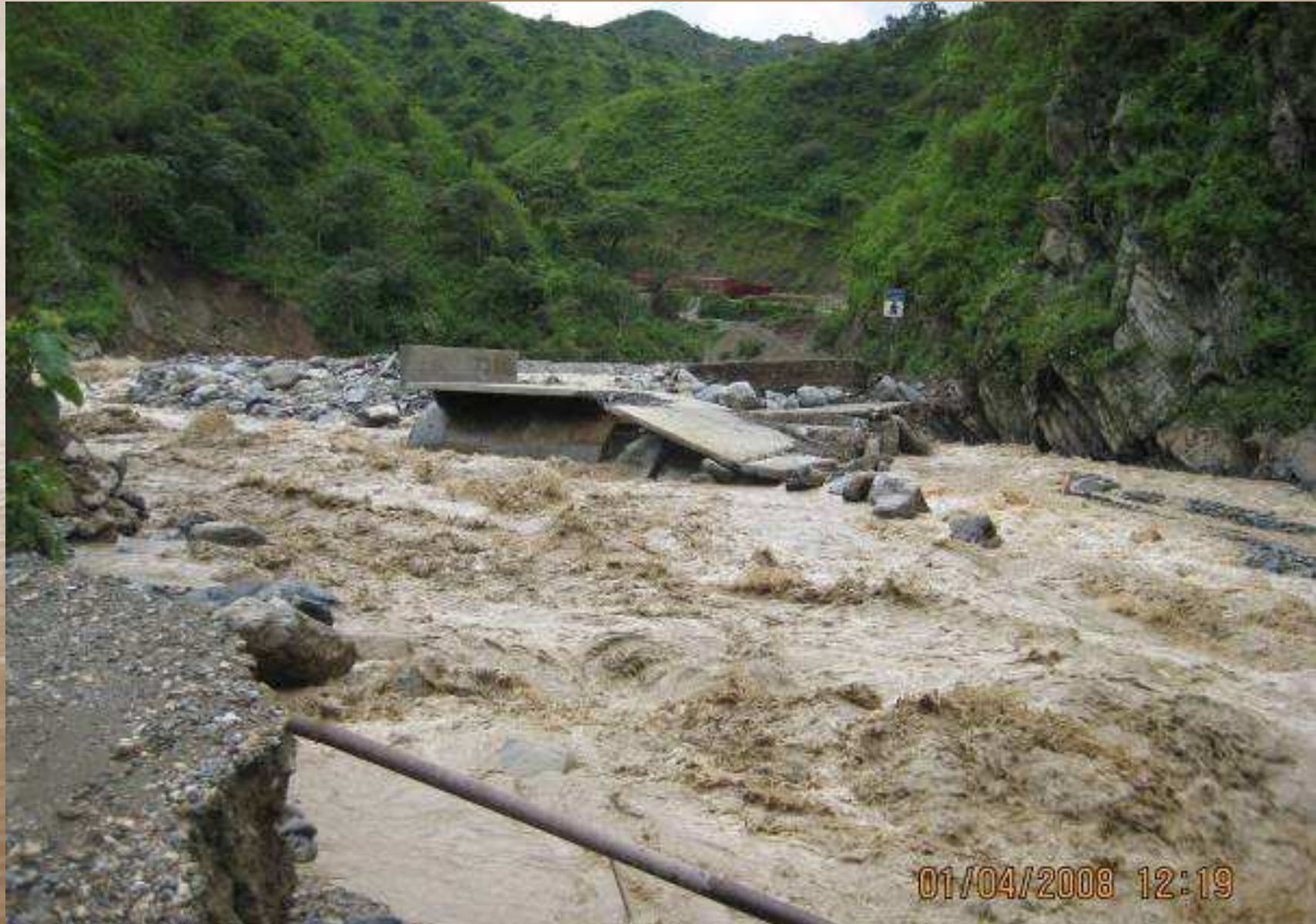
DESTRUCCIÓN DE PUENTE DE ACCESO HACIA PLATAFORMA TBM
