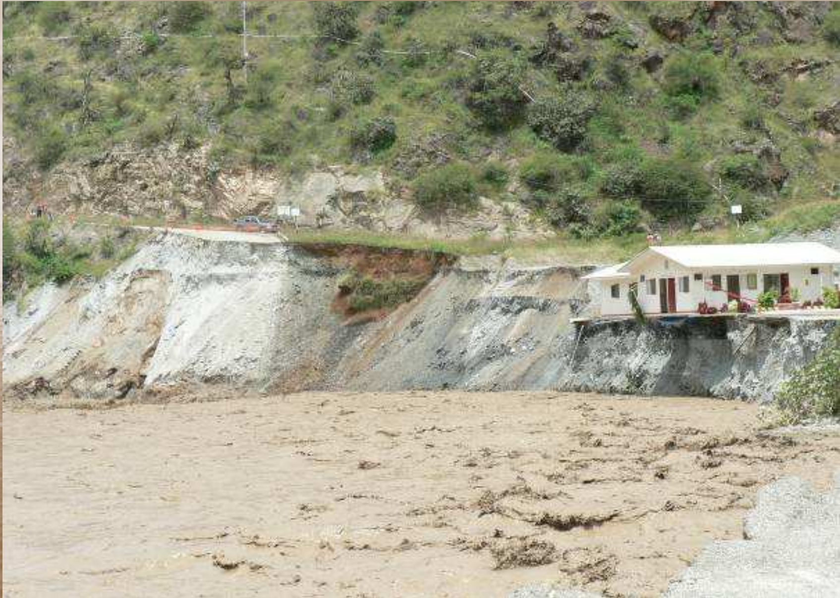
SOCAVACIÓN DE PLATAFORMA DE OFICINAS ADMINISTRATIVAS Y POSTA MÉDICA
