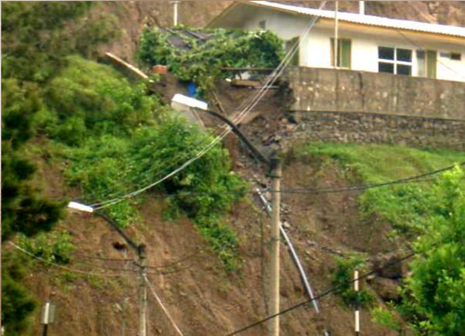
EROSIÓN DE PLATAFORMA DEL PABELLÓN DE ALOJAMIENTO DE GERENCIAS
