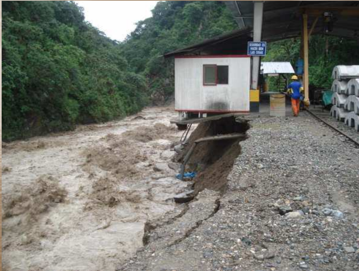
SOCAVACIÓN DE PLANTA DE FABRICACIÓN Y ACOPIO DE INVERTS
