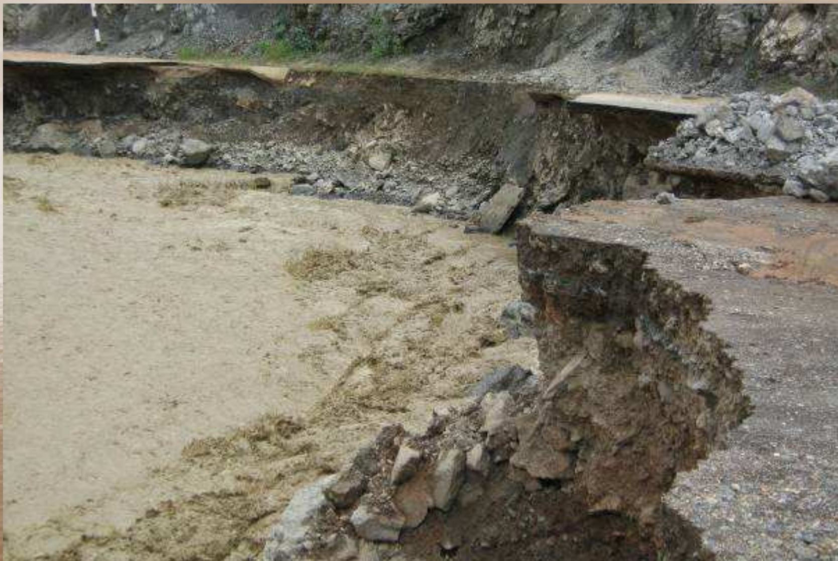
KM 62. PÉRDIDA TOTAL DE LOS CARRILES – SOCAVACIÓN ORIGINADA POR RIO HUANCABAMBA
