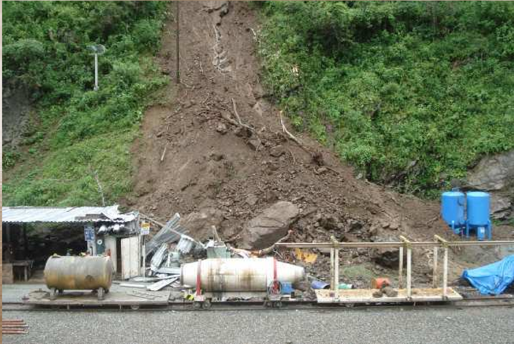
DESLIZAMIENTO SOBRE PLATAFORMA TBM
