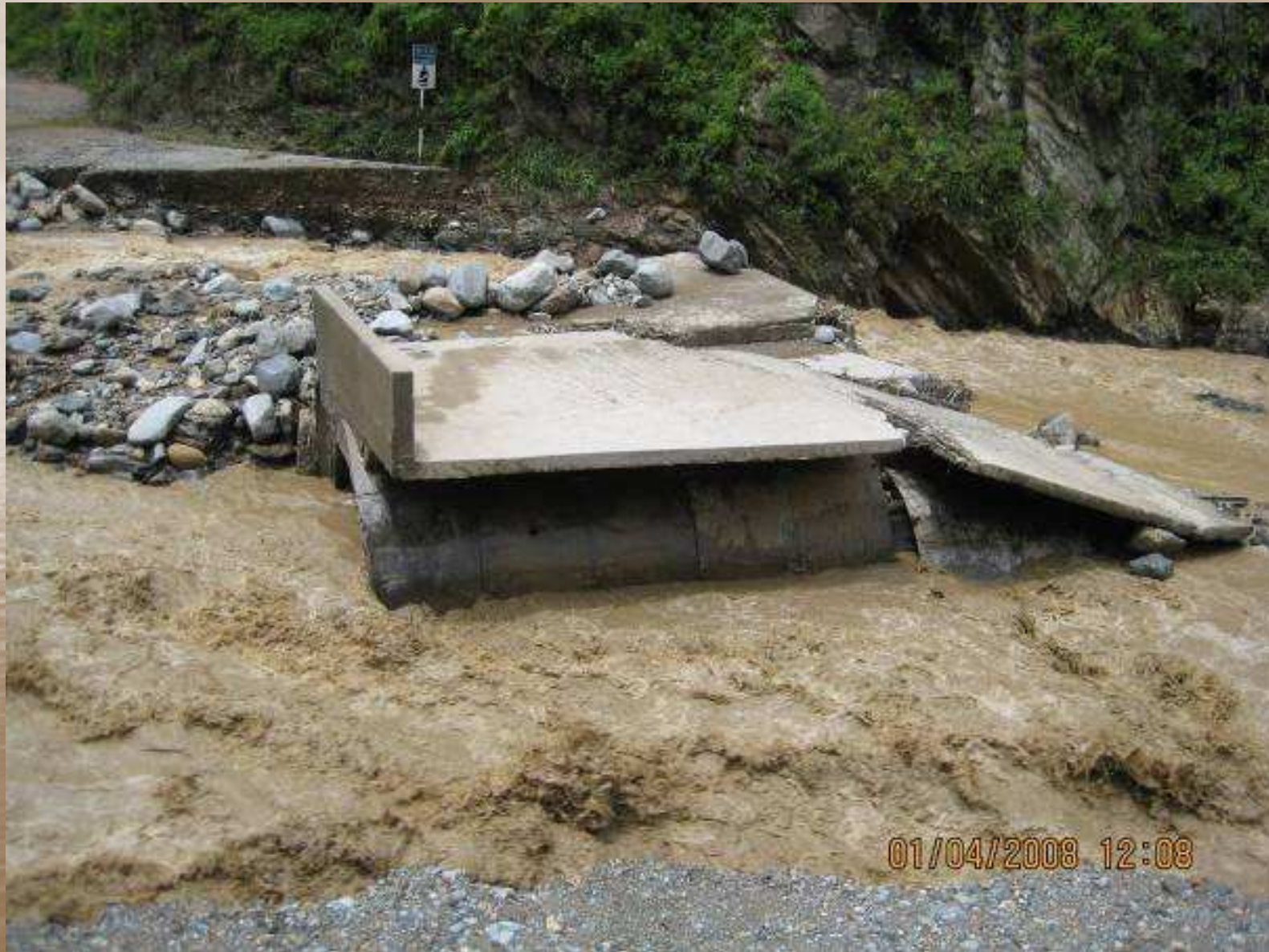
DESTRUCCIÓN DE PUENTE DE ACCESO HACIA PLATAFORMA TBM
