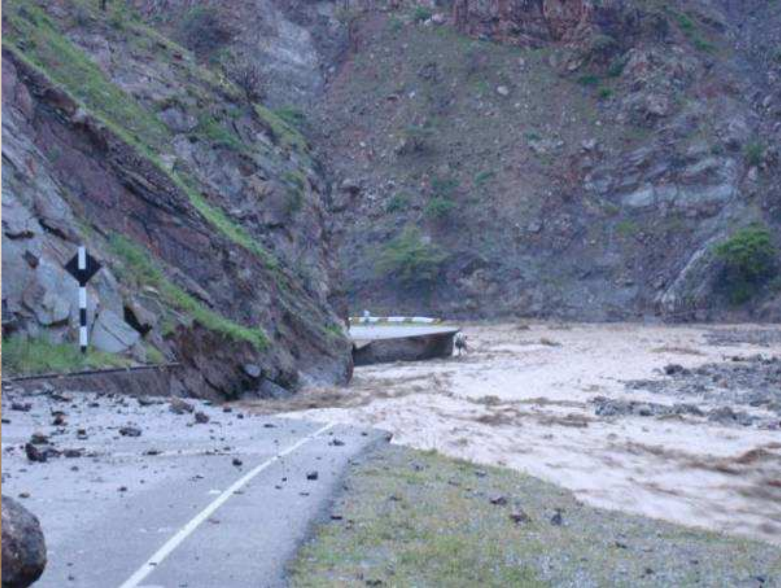
KM 82. DESTRUCCIÓN TOTAL DE PLATAFORMA
