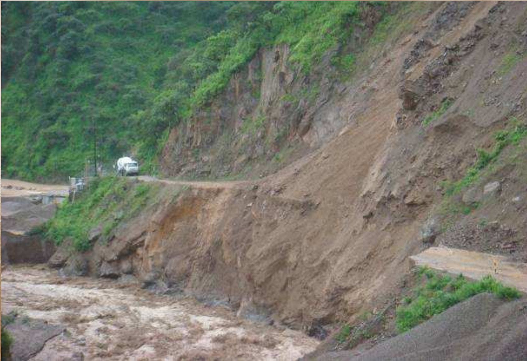
DERRUMBE Y DESTRUCCIÓN DE PLATAFORMA DE CARRETERA POR SOCAVACIÓN DEL RIO OLMOS
