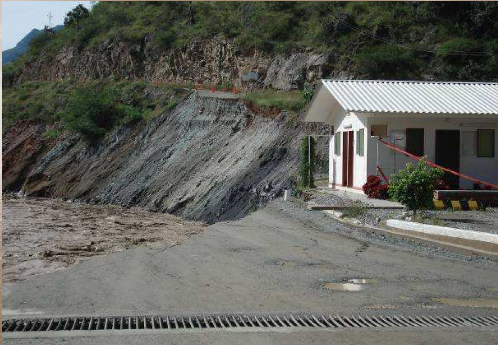
DESTRUCCIÓN DE CAMINO DE ACCESO A ZONA DE ALOJAMIENTOS Y POLVORÍN VISTA AGUAS ARRIBA
