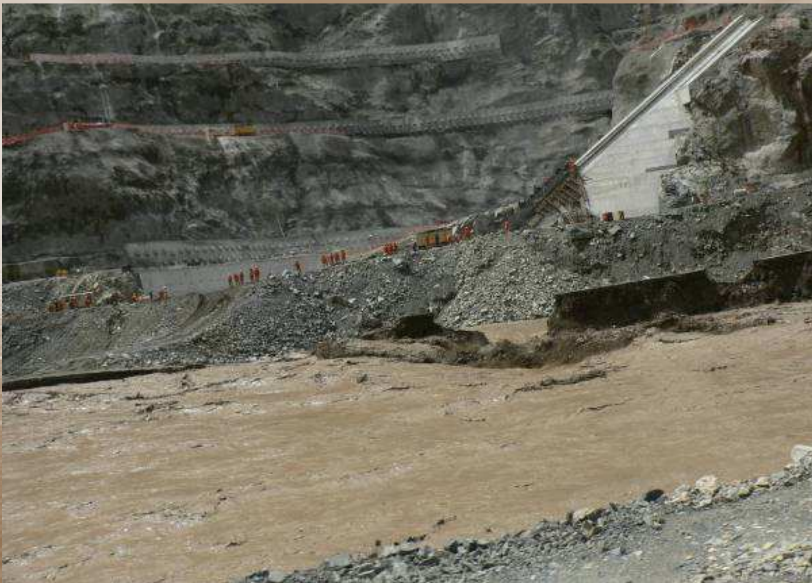
EROSIÓN DE ZONA ADYACENTE AL ALVIADERO
