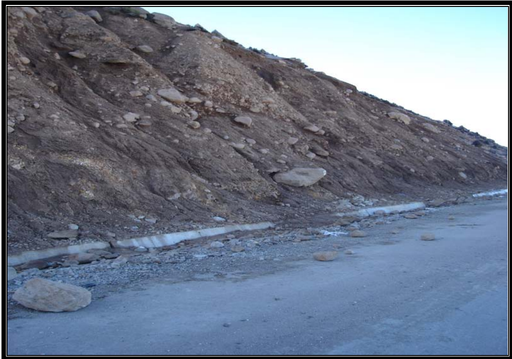
Zona expuesta a derrumbes en el tramo de Patapampa
